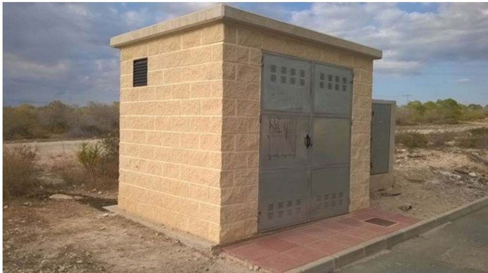
Impulsión a la depuradora
